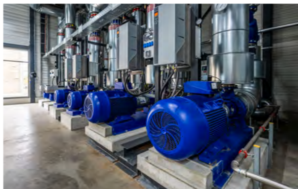
Zuverlässig und effizient: Pumpen von KSB in einem Biomassekraftwerk
