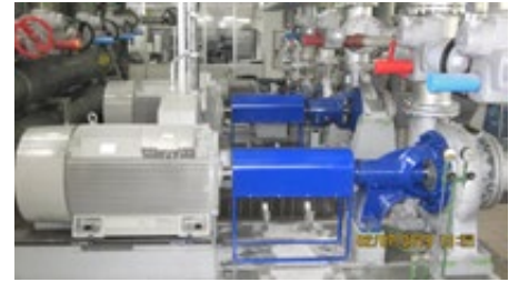
Pompes de surface, moteurs asynchrones
