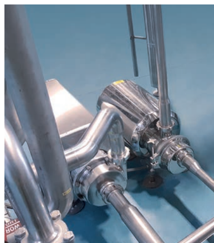
Vitachrom och Vitaprime uppfyller de högsta hygienkraven i det tillbyggda brygghusets källare.
