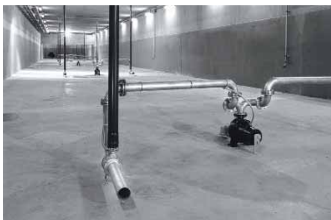
Dešťová nádrž s objemem smíšené vody 22 500 m 3 a plochou o rozloze 4 300 m 2 . 24 čerpadel KSB Amajets, celkový výkon 384 kW.
